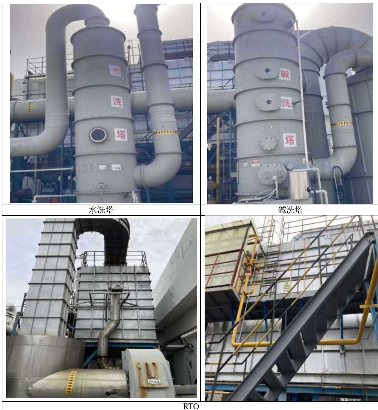
图 3.6.1-1 厂区废气治理措施现状照片
