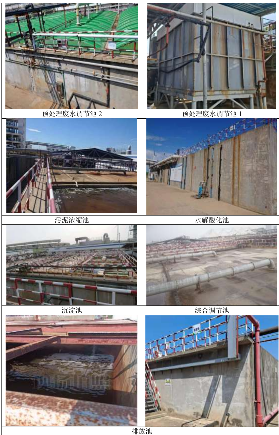
图 3.6.2-3 厂区污水处理站现状
